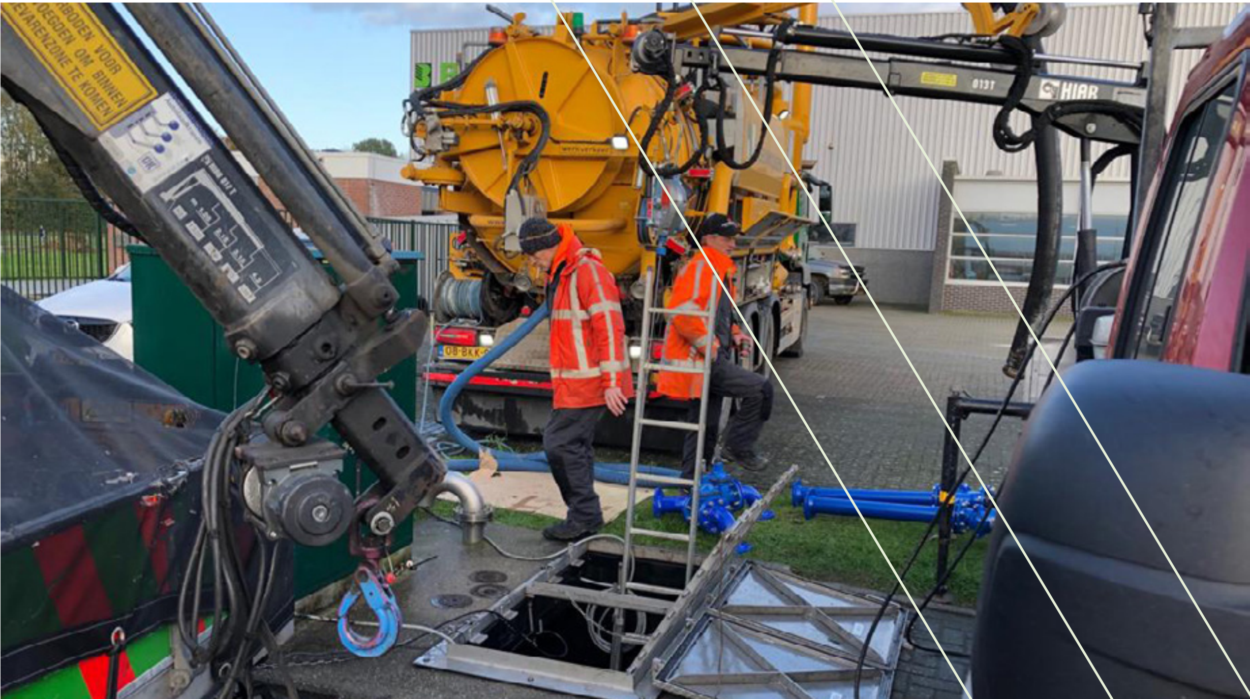
Door rioolgemalen op tijd te renoveren blijft de bedrijfszekerheid gegarandeerd. Hiermee behouden we een robuust systeem voor de afvoer van afvalwater.
